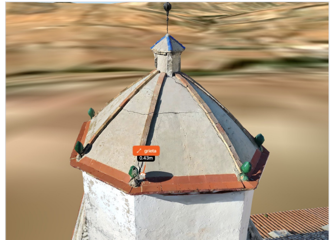
MEDICIÓN REAL · GRIETA 0,43 m
